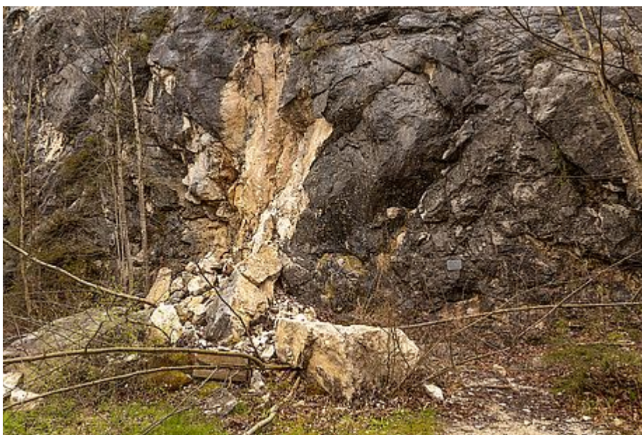
Der Felssturz in Flintsbach (Foto: 16.4.23)
